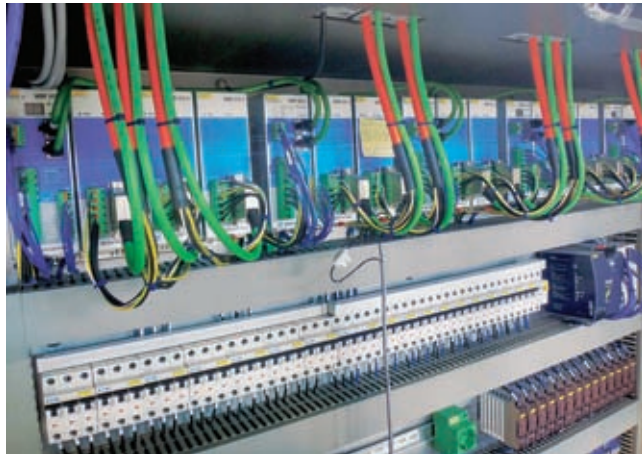
Zur präzisen Steuerung der Servomotoren ist das modulare Multiachs-Servosystem »Dias-Drive MDD 100« von Sigmatek im Einsatz.
