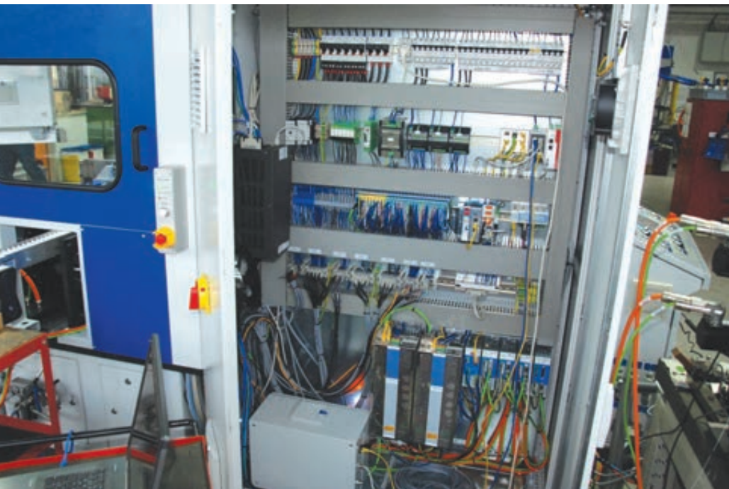
Blick in den Schaltschrank: Ob Steuerungs- und I/O-System »S-Dias« inkl. Safety-Module oder »Dias Drive«-Servoantriebe – bei Sigmatek schöpft SBT aus dem Vollen. Als Bedienschnittstelle kommen »ETV«-Touchpanels zum Einsatz.
