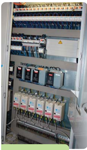
Bild 5: Bei der Produktion von Biogas ist eine Vielzahl an Frequenzumrichtern im Dauereinsatz. Ein robustes Ethernet-Netzwerk wie Varan ermöglicht eine hohe Verfügbarkeit.
