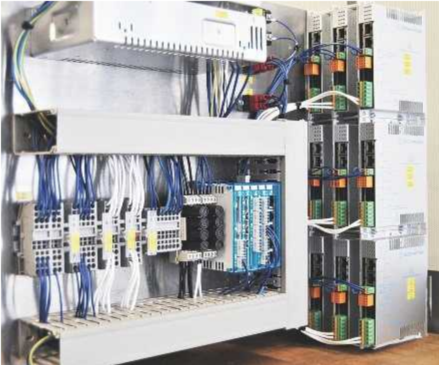
Beim 3D-Drucker 140L ist das gesamte Automatisierungssystem in einem einzigen Schaltkasten untergebracht. Rechts sind die bis zu zwölf Achsen montiert.
