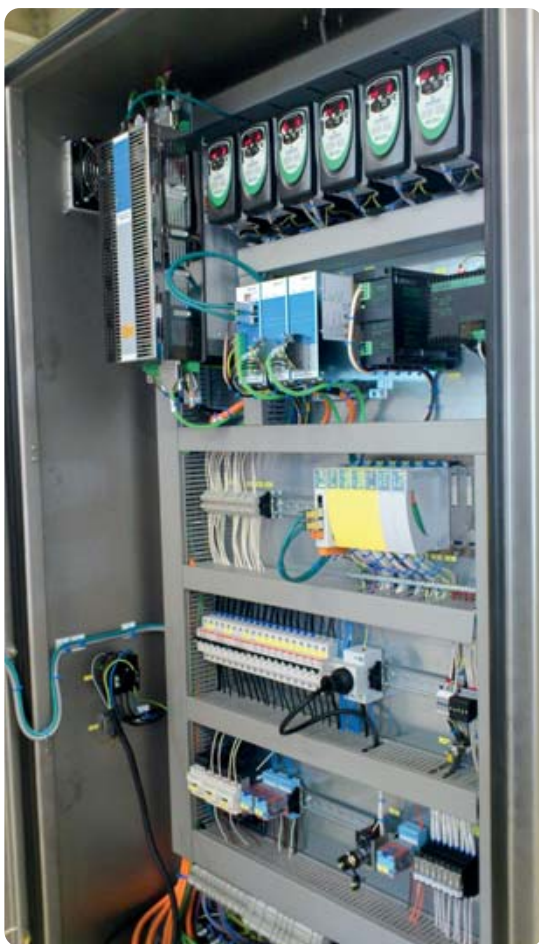
Bild 5: Die Sigmatek-Lösung im Schaltschrank umfasst Standard- und Safety-I/O-Module der kompakten Baureihe C-Dias sowie Antriebe der modularen Serie Dias-Drive 100 (oben Mitte) und das Drei-Achsgerät Dias-Drive 300 (ganz links oben). Die Systemkommunikation läuft über den Industrial Ethernetbus Varan.
