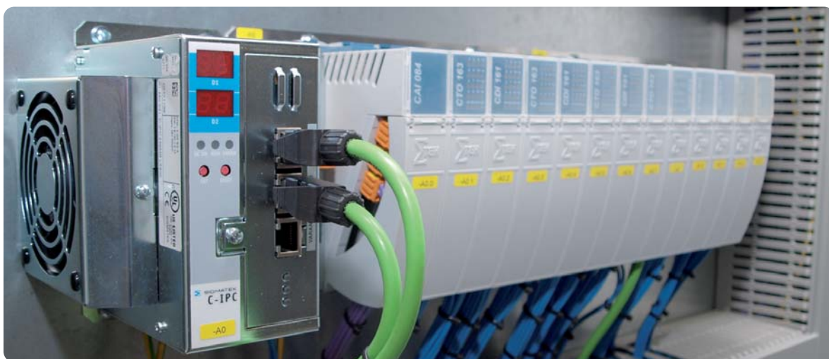
Bild 4: Bei Hirsch kommen standardmäßig die 'C-IPCs' von Sigmatek – modular erweiterbar mit digitalen und analogen Ein-/Ausgangs- sowie Safety-Modulen der 'C-Dias'-Baureihe – als steuerungstechnisches Herz sämtlicher Maschinen und Anlagen zum Einsatz.
