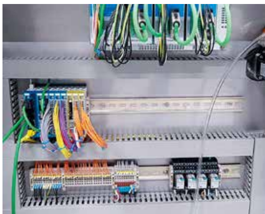
Die modularen Dias-Drives 100 von Sigmatek steuern die Servomotoren an und kommunizieren mit z. B. SinCos-Schnittstellen. In dieser Konfiguration werden Transport- und Fließbänder angesteuert. Das S-Dias-Steuerungssystem mit integrierter Safety sorgt in Kombination mit dem Ethernetbussystem VARAN für Datenkommunikation in harter Echtzeit.
