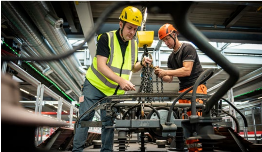
Auf den Dacharbeitsbühnen ist das Tragen von Absturzsicherungen nicht zwingend vorgeschrieben. Dennoch greifen die implementierten Sicherheitsfunktionen des Krans . So kann dieser nur aus seiner sicheren Parkposition bewegt werden, wenn die Fahrleitungsidentifikationen (links und rechts im Bild) auf grün stehen.
