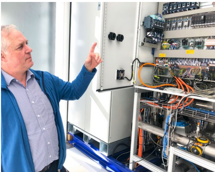
Bernd Maus am Schaltschrank. Er betont: „Die gute, direkte Betreuung war für uns ein wichtiges Argument, mit Sigmatek zusammen zu arbeiten.“
