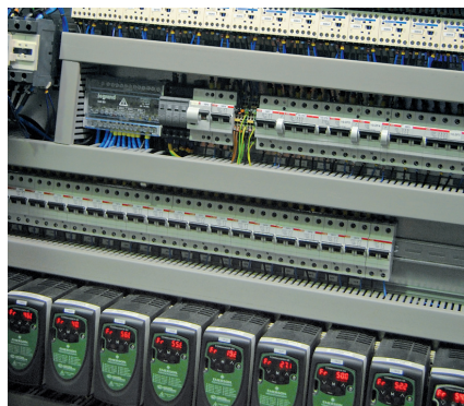
Übersicht im Schaltschrank: Die CPU des Sigmatek C-DIAS Systems steuert ca. 300 I/Os und übernimmt die Navigation der Frequenzumrichter für ca. 35 AC-Motoren.
