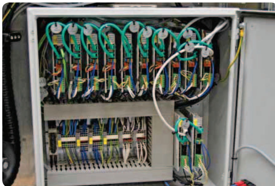
Beim größeren Modell Hage3D 140L ist die Automatisierungstechnik auf zwei Schaltkästen aufgeteilt. Der Leistungsteil nutzt zur Ansteuerung der Schrittmotoren die Schrittmotor-Endstufen VST 011 von Sigmatek.
