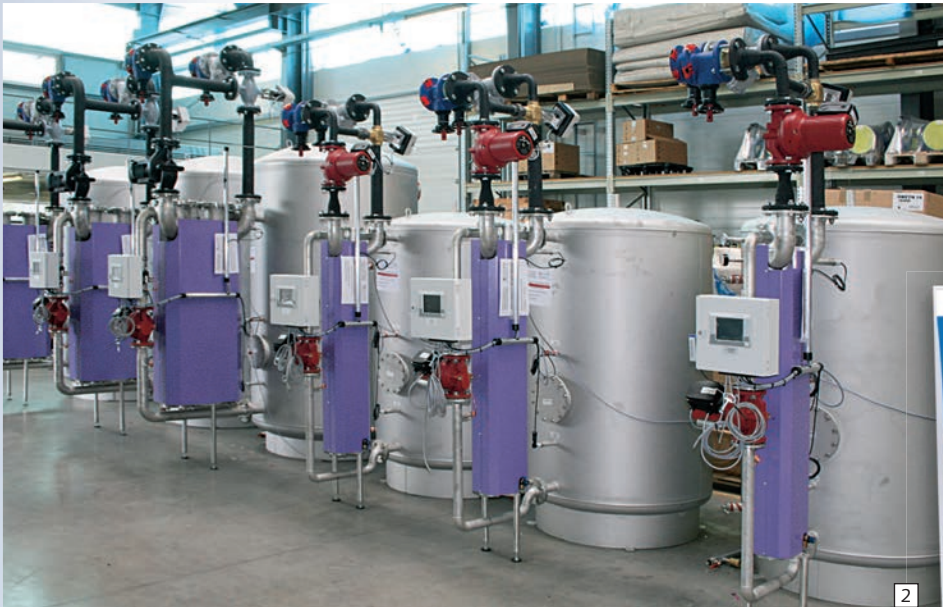
Bild 2: Die Wärmetauscher für die Warmwassererzeugung sind besonders energieeffizient. Steuerung und Visualisierung erfolgen mittels Control Panels HZS 555 mit 5,7-Zoll-VGA-TFT-LCD-Farbtouchscreen und Edge-Technology von Sigmatek.
