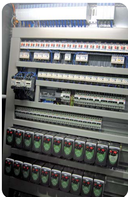
Bild 4: Übersicht im Schaltschrank: Die CPU des Sigmatek C-DIAS Systems steuert ca. 300 E/As und übernimmt die Navigation der Frequenzumrichter für 35 AC-Motoren.
